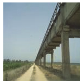
Vista do canal principal de rega do Aproveitamento Hidroagrícola do Mira, no Monte do Canto
